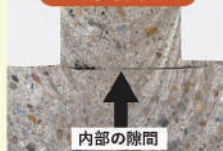
施工不良の例
