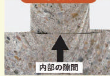
施工不良の例
